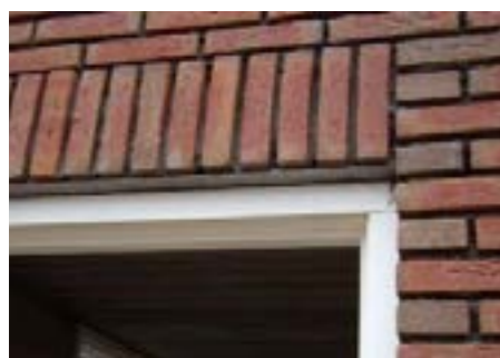
Afwijken metselverband boven ramen/deuren
